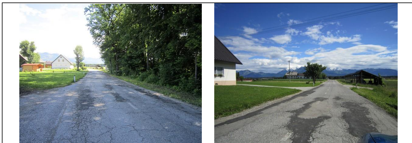
Slika 17: Nevaren odsek ceste brez pločnika do avtobusne postaje Benk, zaradi velikih hitrosti vozil.
